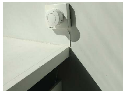
Figuur 60: Voorbeeld van een verplaatste thermostaatkraan
