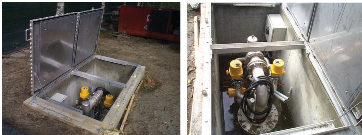
Figuur 44: Collectorput geo-cooling open systeem.
