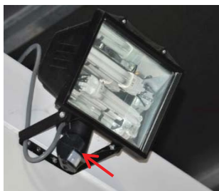
Figuur 86: in het armatuur geïntegreerde sensor
