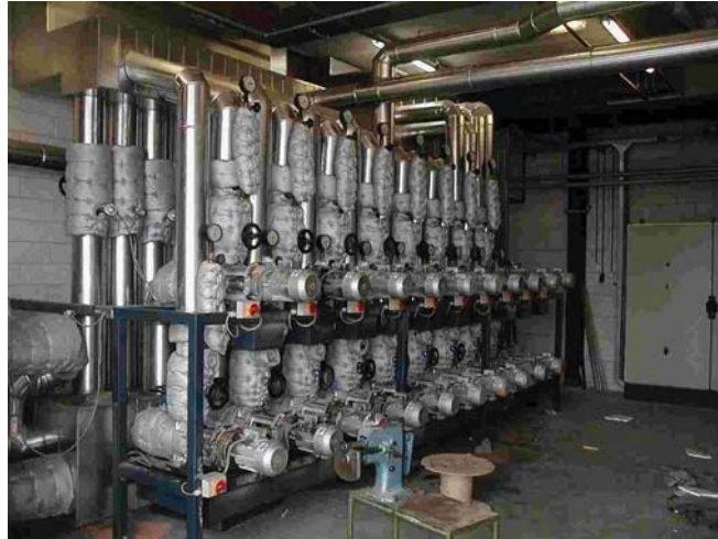
Figuur 121: Collectief onderstation met aparte circulatiepomp per kring.
