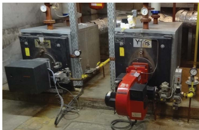
Figuur 31: Voorbeelden van ketels uitgerust met opbouwbranders
