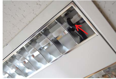
Figuur 92: Daglichtsensor op TL-verlichting in een armatuur
