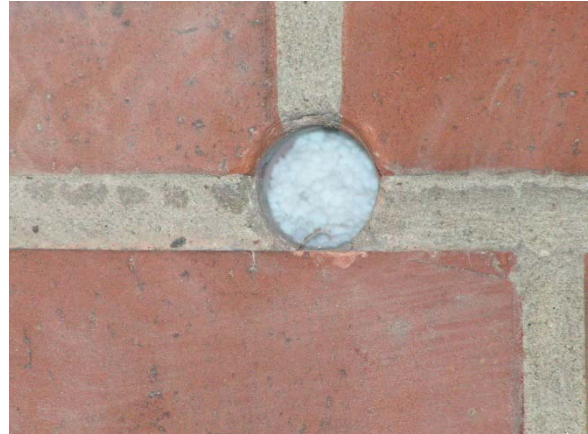
Figuur 65: Inblaasopening bij na-isolatie
