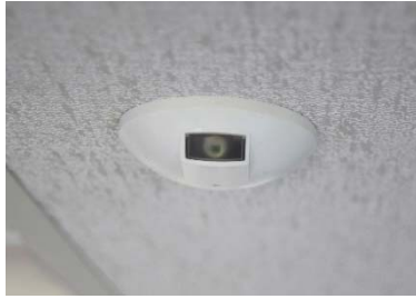
Figuur 91: Daglichtsensor aan het plafond
