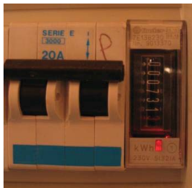
Figuur 140: Extra elektriciteitsteller
