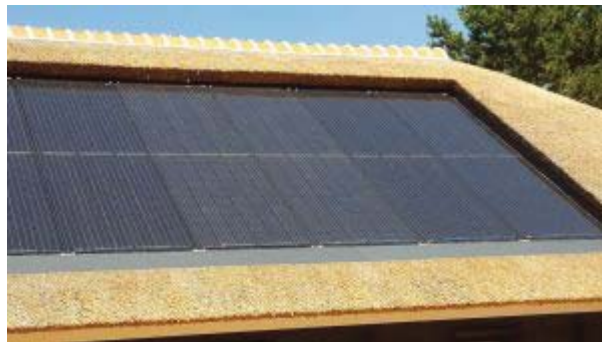
Figuur 239: PV-panelen geïntegreerd in een rieten dak.
