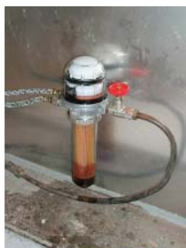
Figuur 123: Stookoliefilter met ontluchtingssysteem
