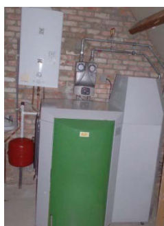
Pelletketel met zuigsysteem en opslag
