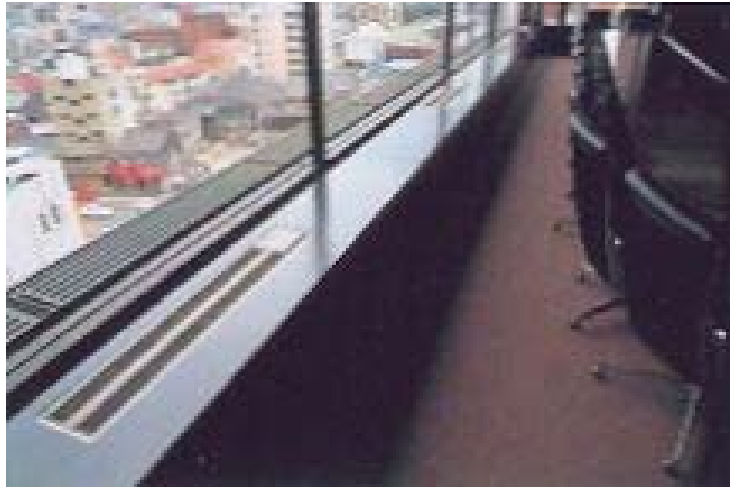
Figuur 202: Ventilconvector ingewerkt onder de ramen
